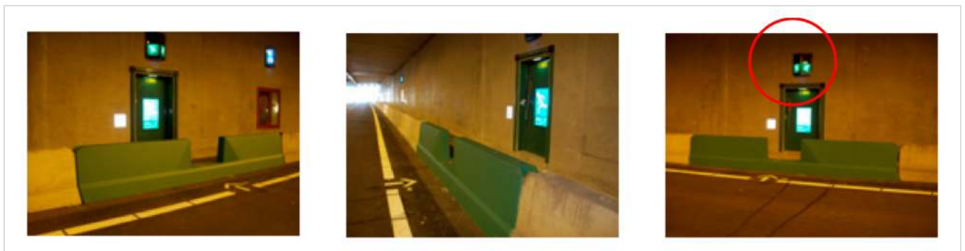
Figuur 378.1 - Locatie stepbarriers A2 Leidsche Rijntunnel
