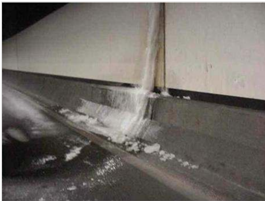
Figuur 269.2 - IJsoverlast in de Drechtunnel
