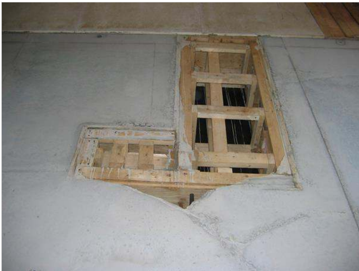
Figuur 654.2 - Onvoldoende voorziening voor toegankelijkheid beton onder sparing
