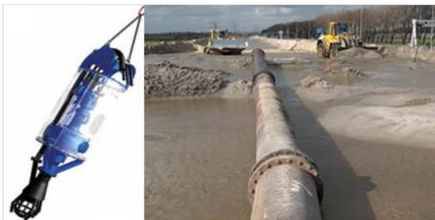
Figuur 597.1 DOP-pomp (links) en transportleiding (rechts)
