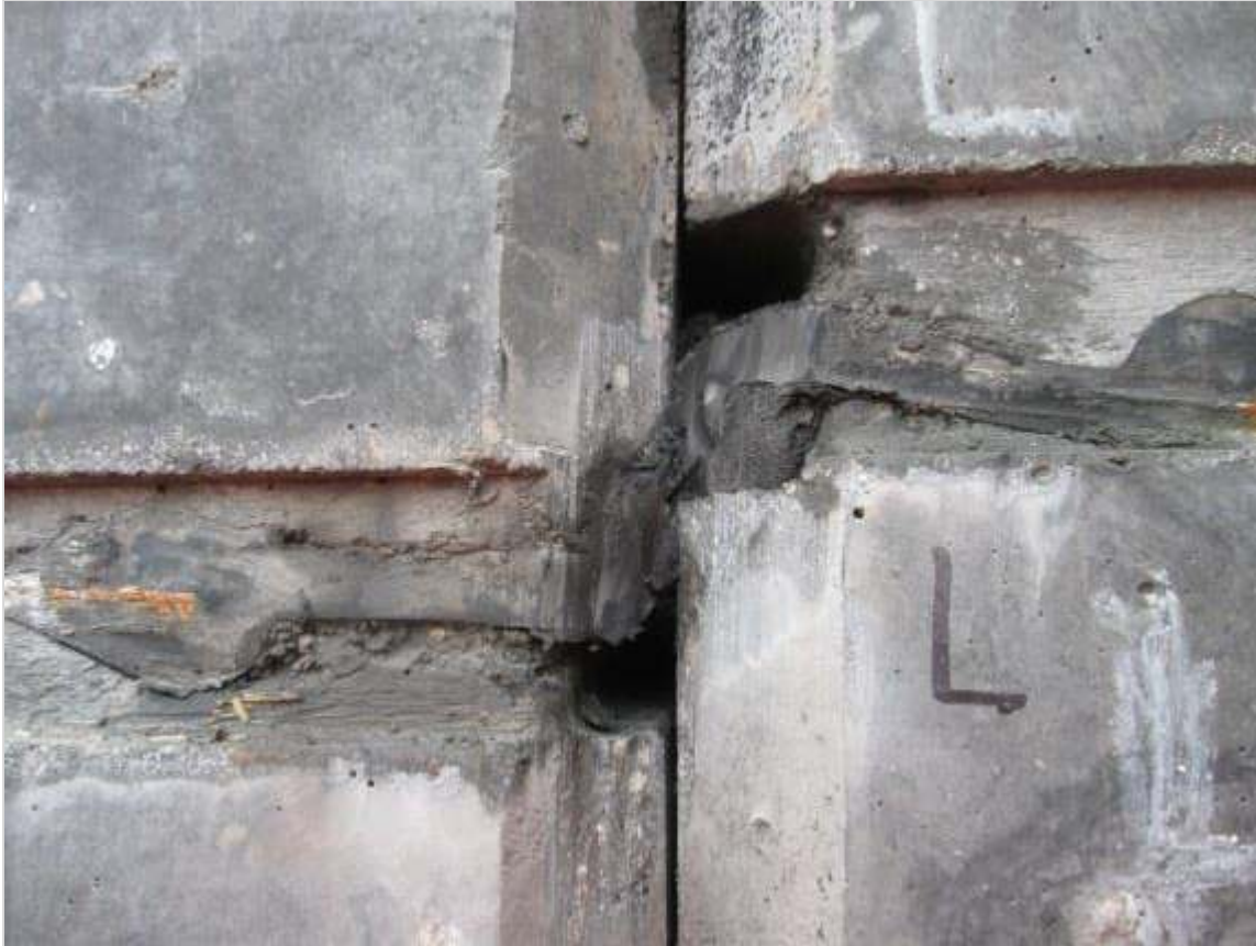
Figuur 369.2 - Beschadiging waterkerend profiel als gevolg van verschilverplaatsing bij zeer geringe voegbreedte
