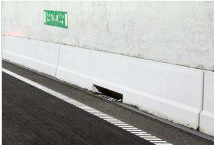
Figuur 387.1 - Inlaatput 2e Coentunnel met ribbelstreep 50-50 mm
