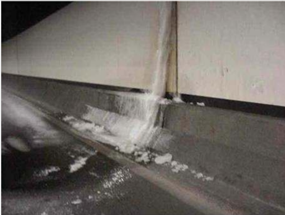
Figuur 269.2 - IJsoverlast in de Drechtunnel
