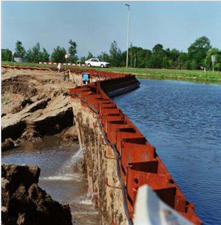
Figuur 134.1 - Bezwijken van de passieve zijde tijdens de ontgraving van de bouwput voor de bouw van het Gaag-aquaduct [ https://beeldbank.rws.nl , Rijkswaterstaat / Rens Jacobs]
