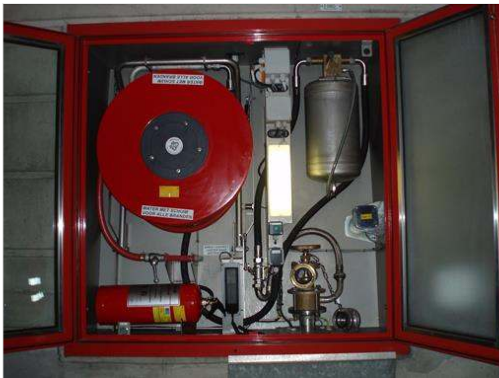
Figuur 461.2 - Hulppost Hubertustunnel
