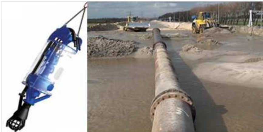
Figuur 597.1 DOP-pomp (links) en transportleiding (rechts)
