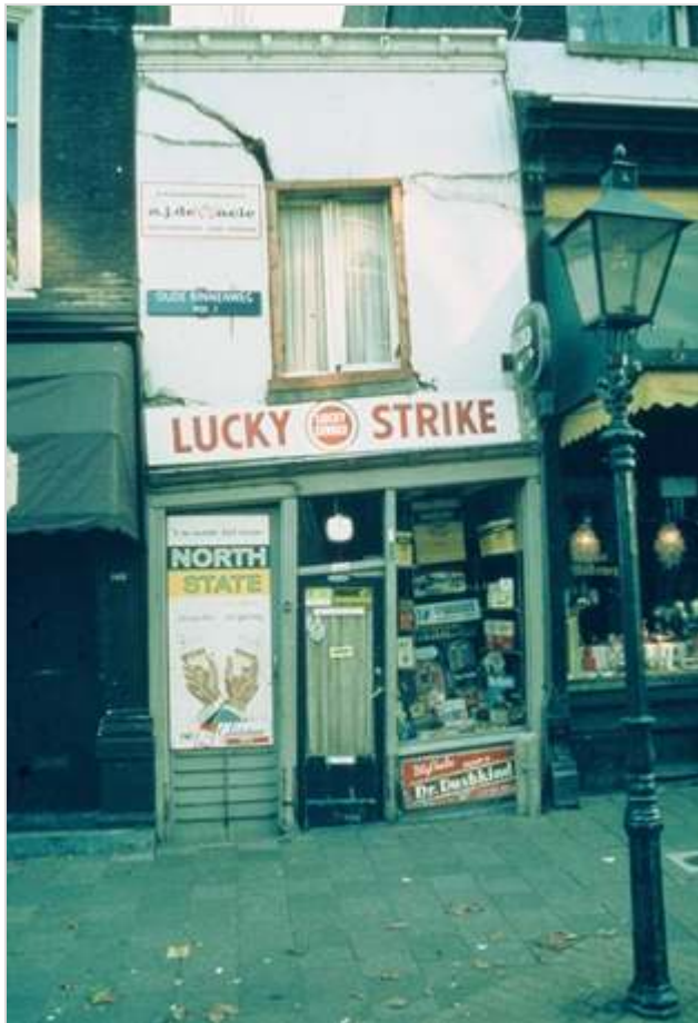
Figuur 146.1 - Een voorbeeld van gebouwschade
