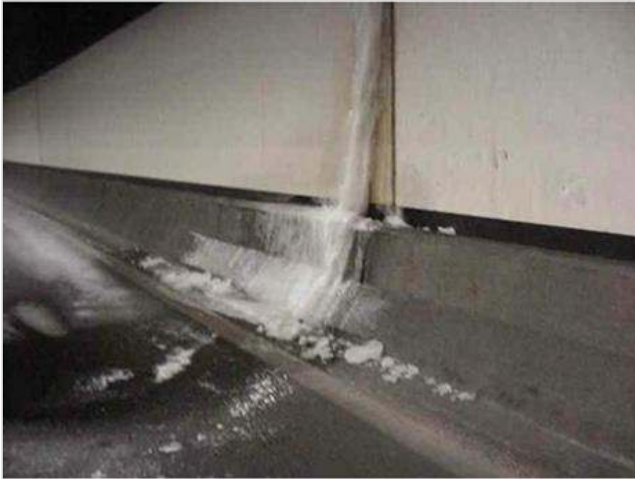
Figuur 269.2 - Ijsoverlast in de Drechtunnel
