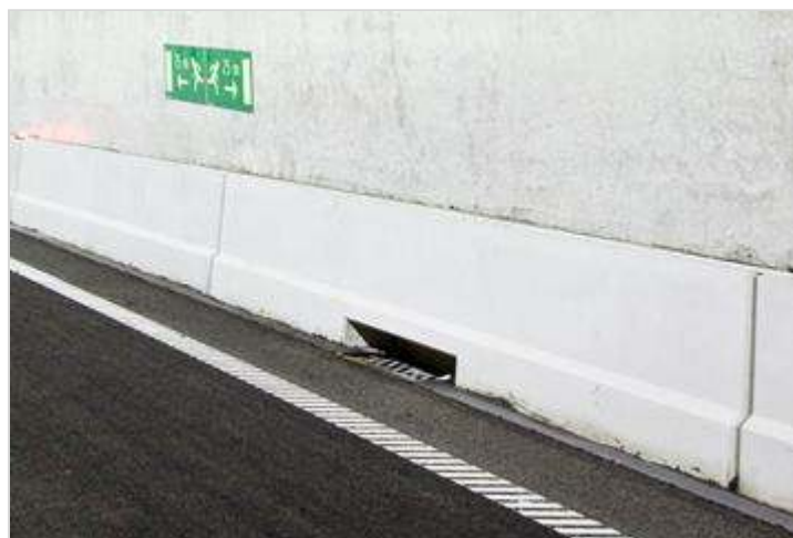
Figuur 387.1 - Inlaatput 2e Coentunnel met ribbelstreep 50-50 mm
