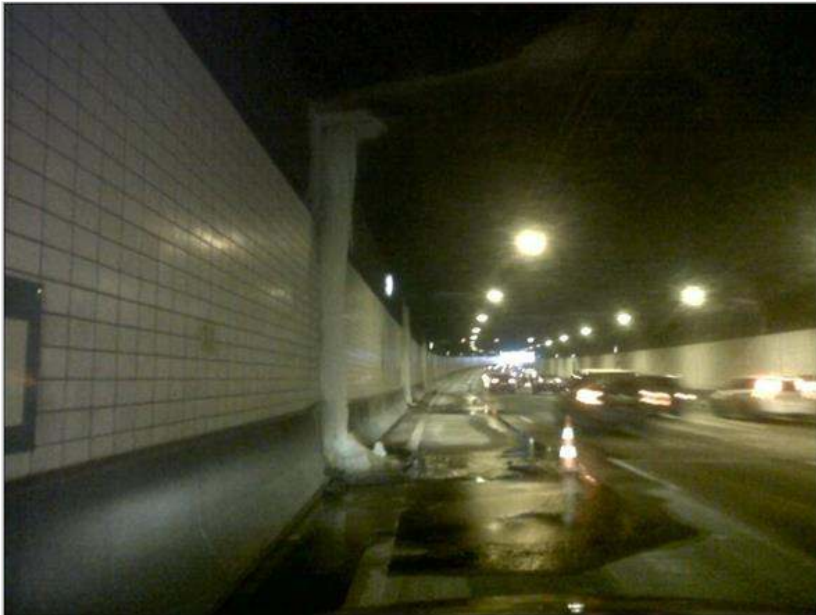
Figuur 255.2 - IJspilaren in de Schiphol tunnel; bevroren lekwater, veroorzaakt door te laag beëindigde waterkerende profielen.
