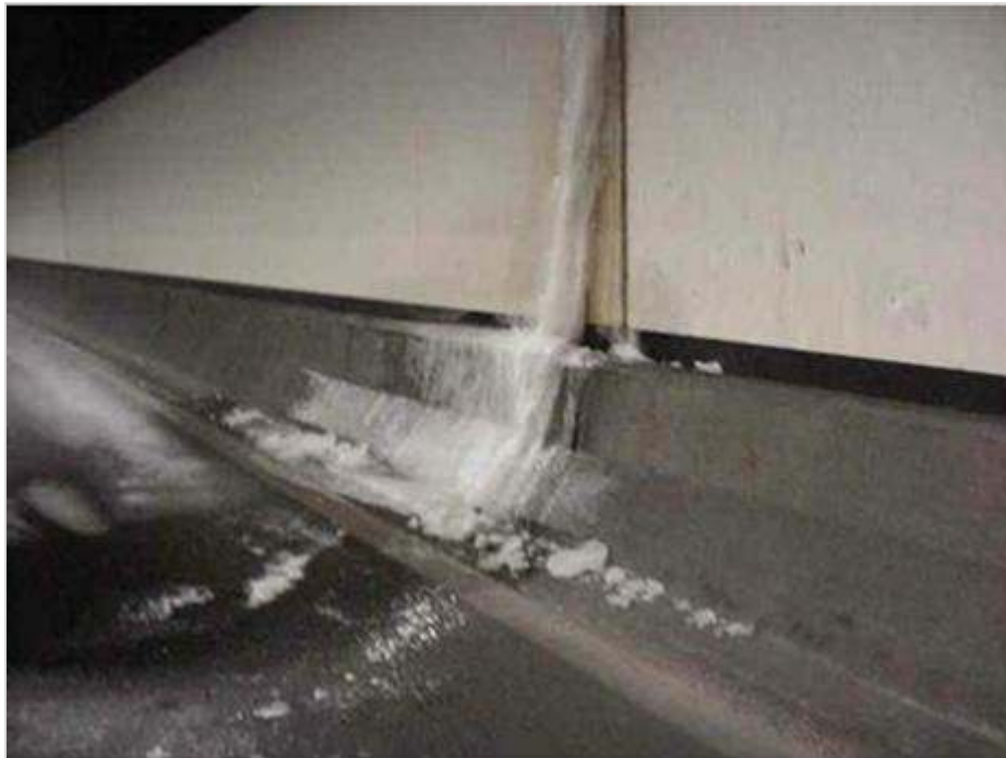
Figuur 269.2 - Ijsoverlast in de Drechtunnel
