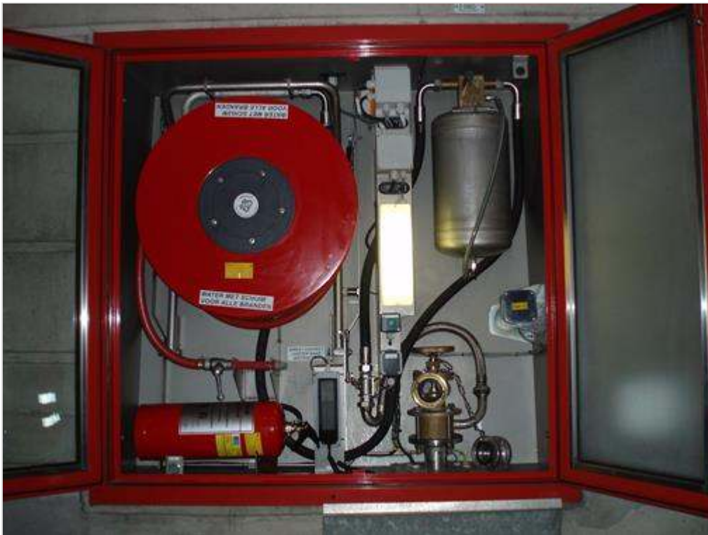
Figuur 461.2 - Hulpkast Hubertustunnel
