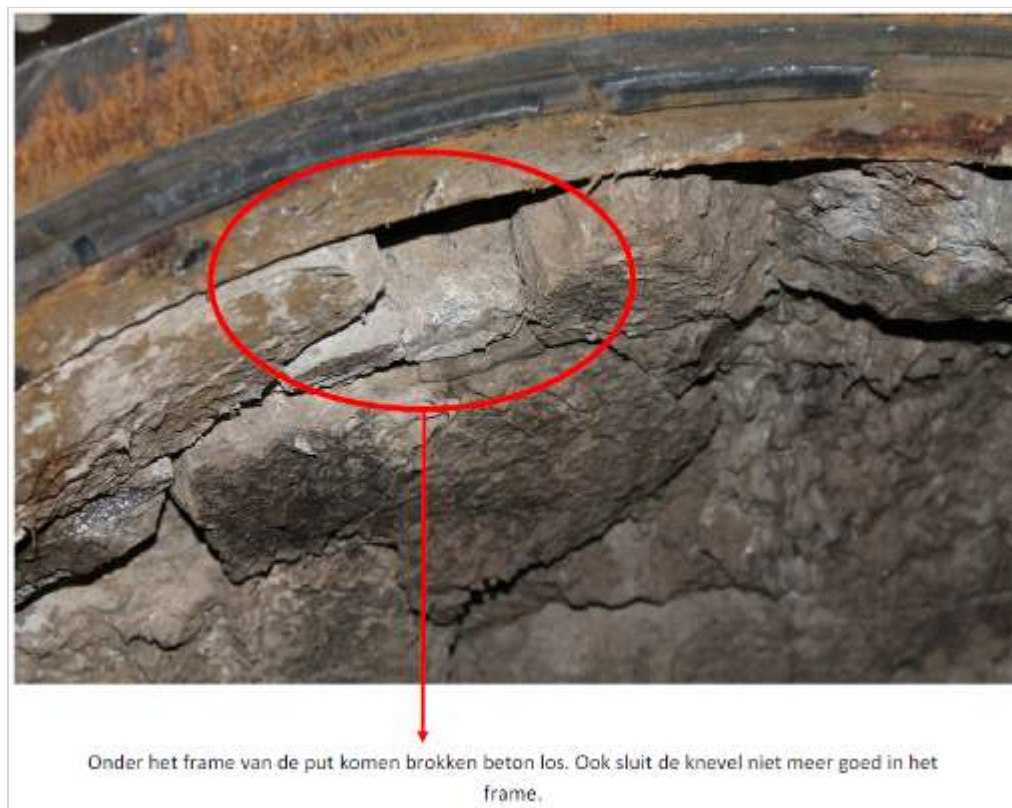
Figuur 385.2 - Beschadiging van het beton onder het frame van de put
