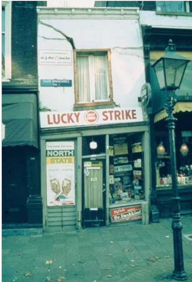
Figuur 146.1 - Een voorbeeld van gebouwschade
