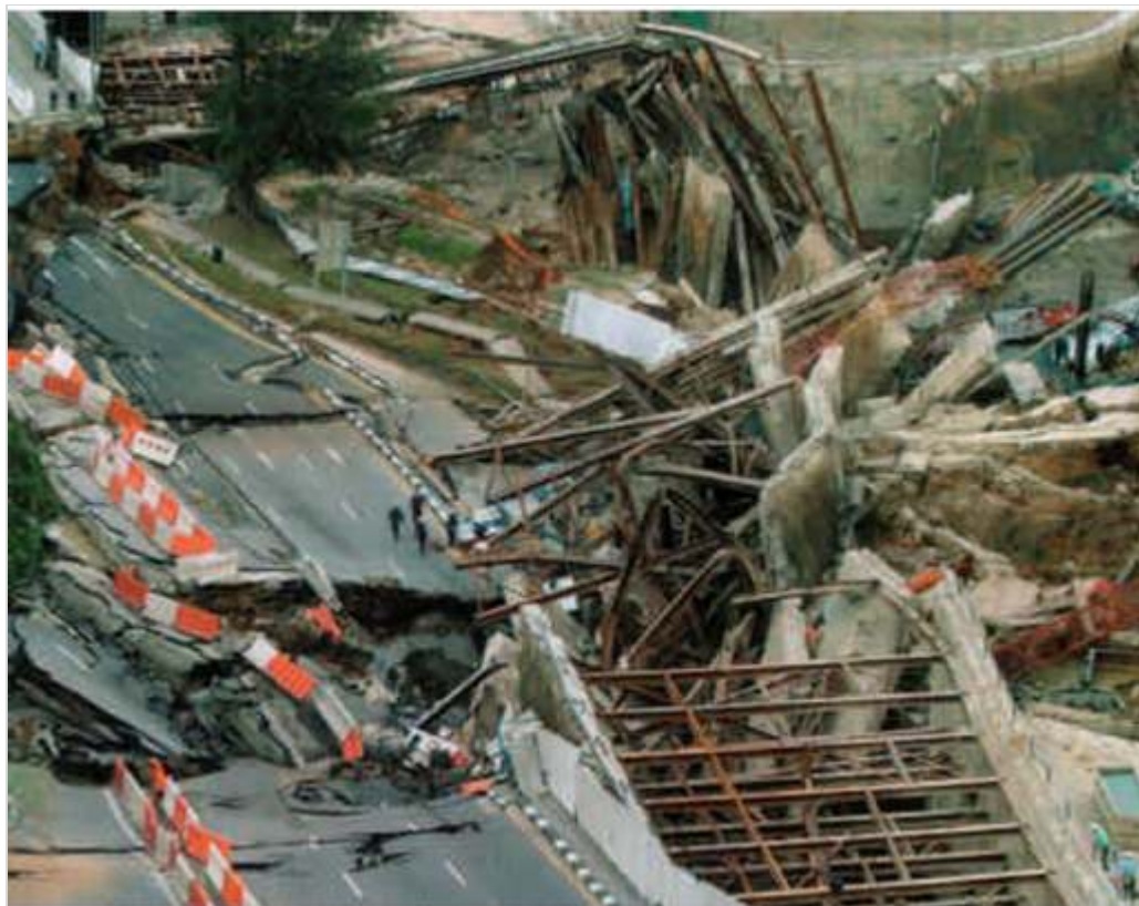
Figuur 136.1 - Het instorten van een bouwput in Singapore
