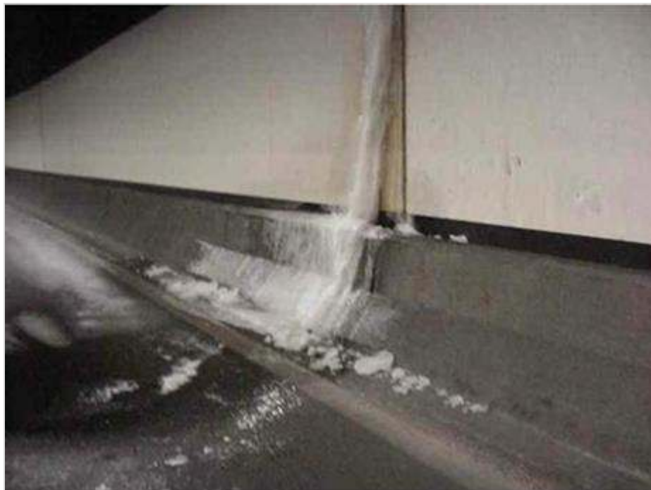
Figuur 269.2 - Ijsoverlast in de Drechtunnel
