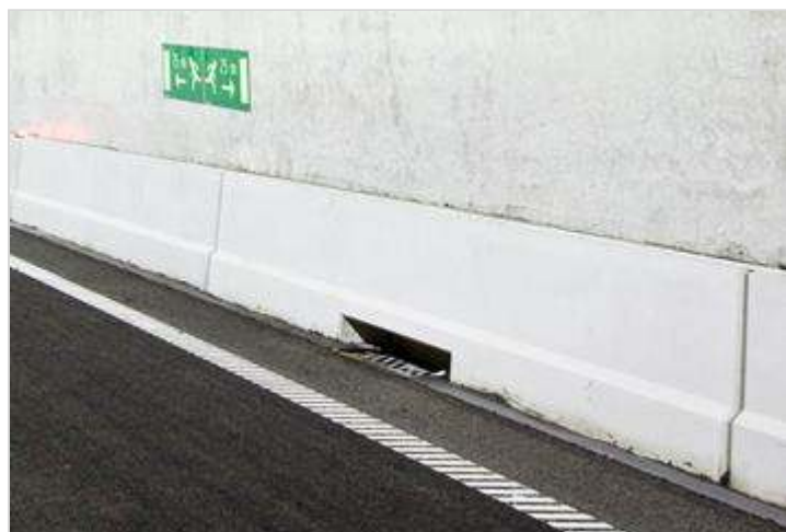
Figuur 387.1 - Inlaatput 2e Coentunnel met ribbelstreep 50-50 mm
