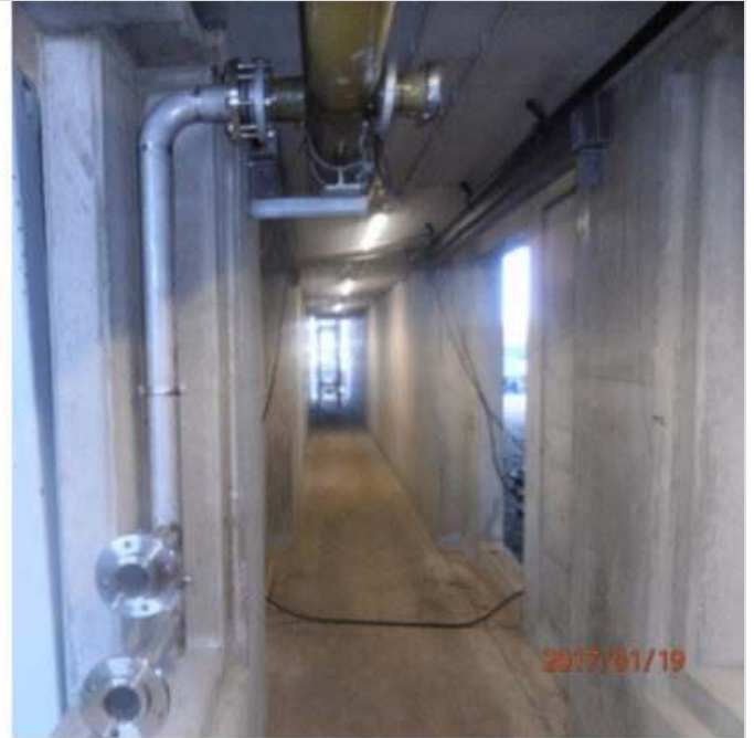
Foto 2: Rechts vluchtdeur sparing en stalen draagbalk vloer dienstgang
