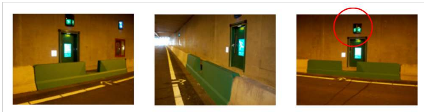
Figuur 378.1 - Locatie stepbarriers A2 Leidsche Rijntunnel
