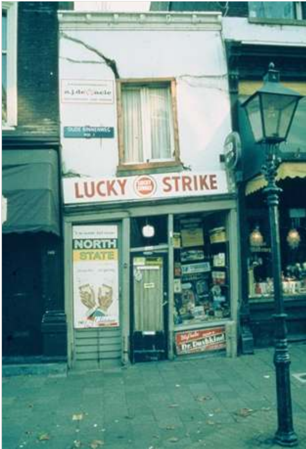
Figuur 146.1 - Een voorbeeld van gebouwschade
