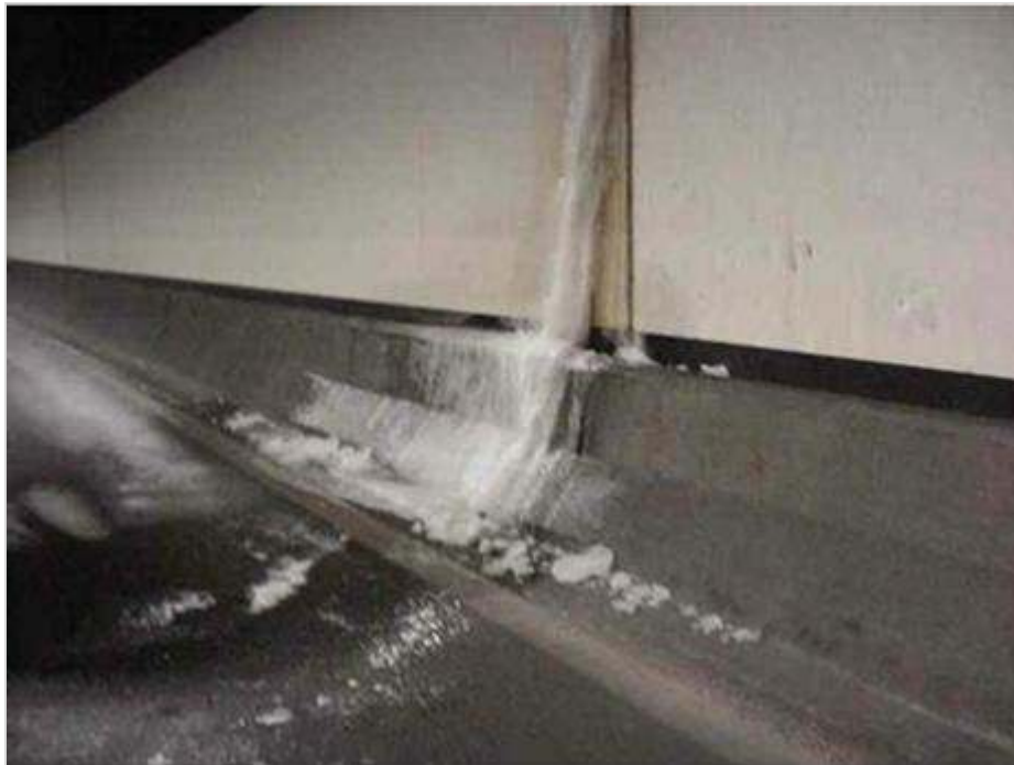
Figuur 269.2 - IJsoverlast in de Drechtunnel
