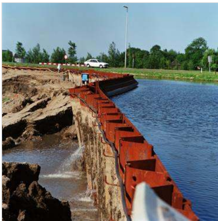
Figuur 134.1 - Bezwijken van de passieve zijde tijdens de ontgraving van de bouwput voor de bouw van het Gaag-aquaduct [159]
