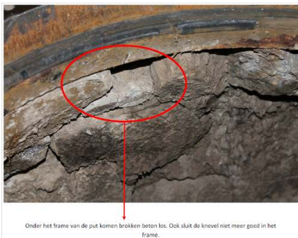
Figuur 385.2 - Beschadiging van het beton onder het frame van de put
