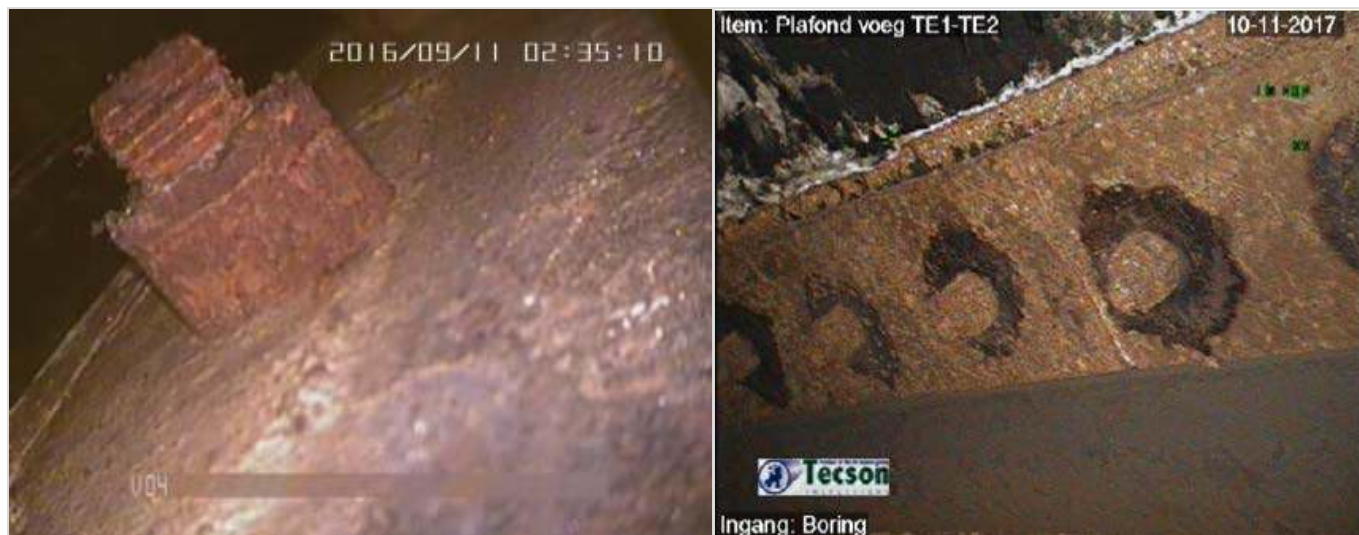
Figuur 357.2 Voorbeeld van bout in goede staat (links, boven asfaltniveau) en aangetast door corrosie (rechts, ter plaatse van splashzone).
