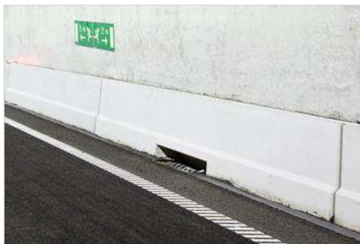
Figuur 387.1 - Inlaatput 2e Coentunnel met ribbelstreep 50-50 mm
