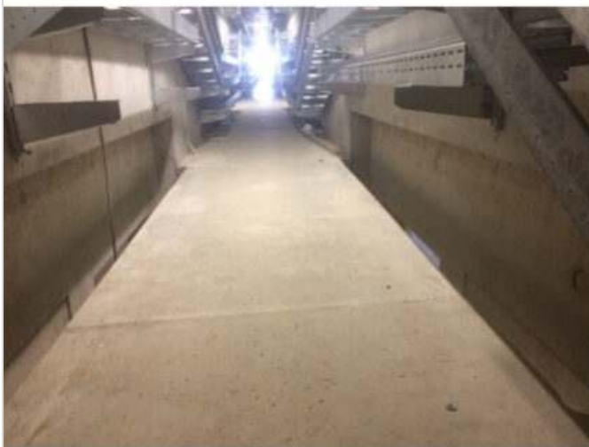
Foto 3: Vloer kabelgang met "brievenbussen" voor ophanging vluchtdeuren
