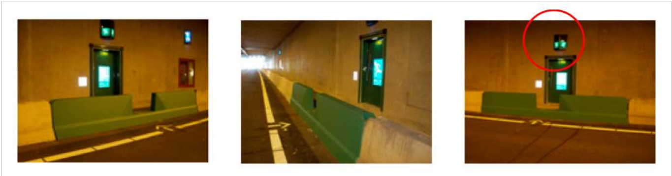
Figuur 378.1 - Locatie stepbarriers A2 Leidsche Rijntunnel
