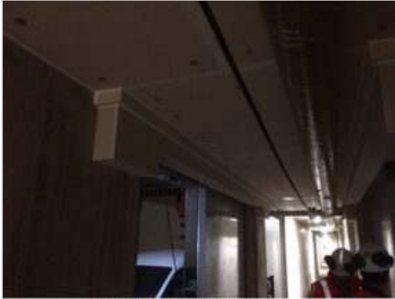
Foto 5: Hwb tegen onderzijde vloer dienstgang.
